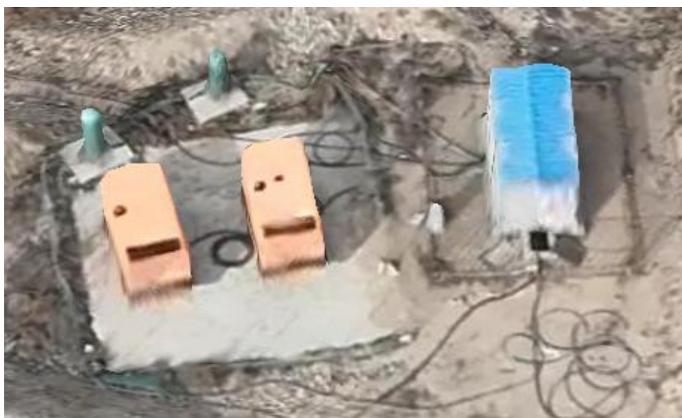
照 3-19 空压机泵站
