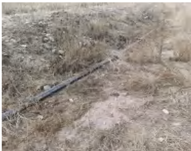
照片 2-6 灌溉管道
